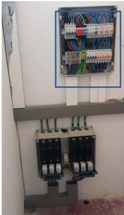
Cuadro de C.A y protección de fusibles líneas a baterías
