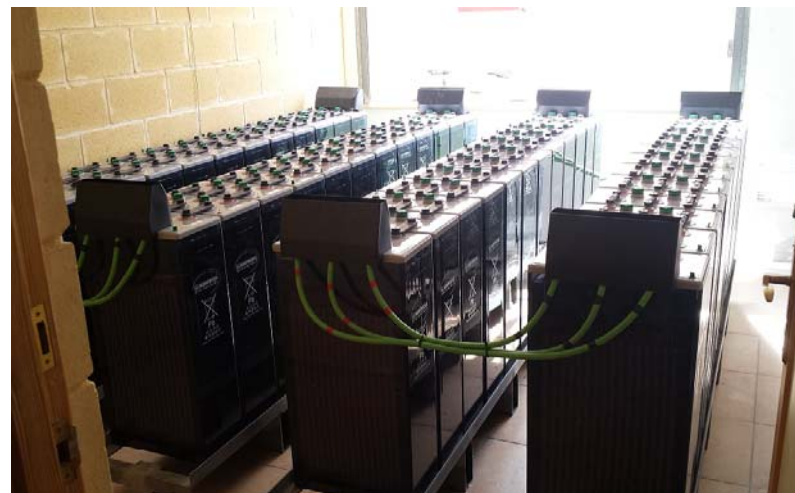
Cuadro de baterías con 48 de 2V.
